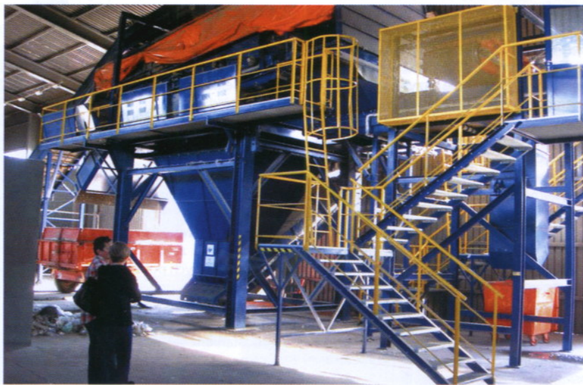
Instalacja do produkcji paliwa formowanego.
